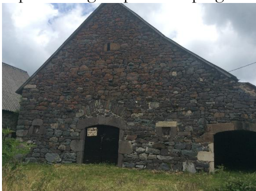
Etable double à Bournioux , très difficile à réhabiliter
